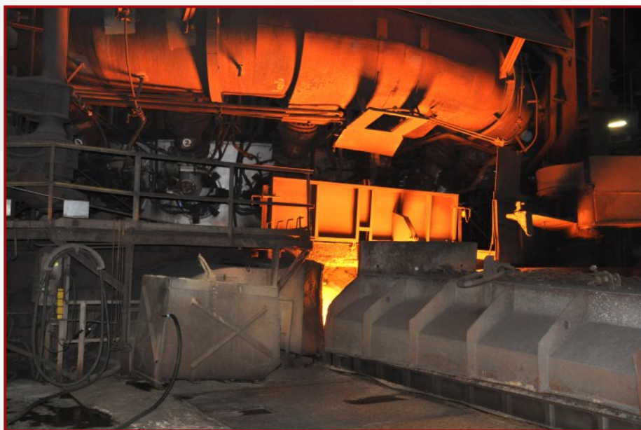
Horní odsávání odpichového otvoru
