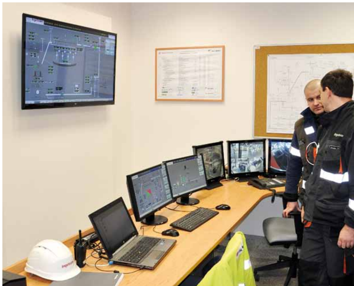
Centrum řízení nové technologie ve velínu PCI.
